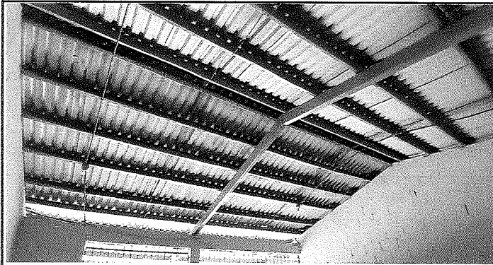
PINTADO CON PINTURA ANTICORROSIVA DE SECADO RÁPIDO A LA ESTRUCTURA METÁLICA DEL TECHO, TRABAJO TERMINADO.
